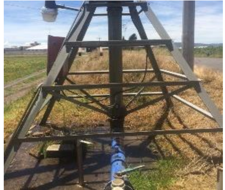
Figura 7. Estructura de la tubería principal para el suministro de agua con el tablero de control
